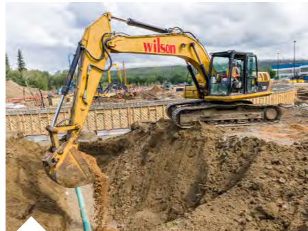
H Wilson installeert een rioolleiding naar het nieuwe Metis-gebouw dat momenteel in aanbouw is. Dit wordt een cultureel gebouw op historische grond.
